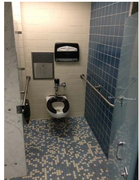
54 Restroom Violation 9E
